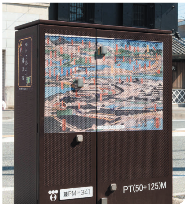
GROUND EQUIPMENT/地上用変圧器 神奈川県藤沢市 街づくり啓蒙活動
